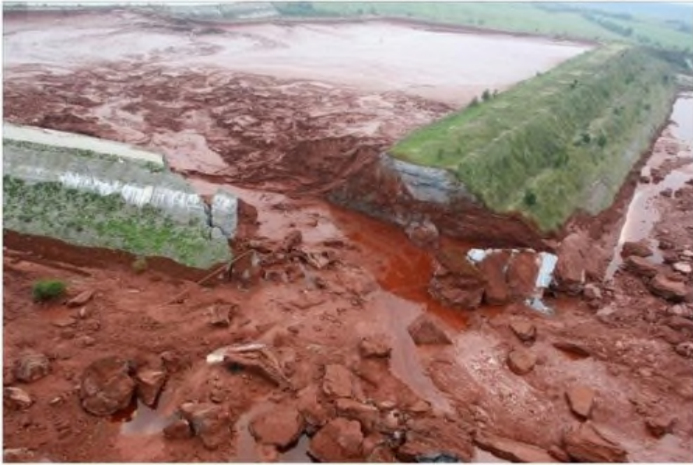
Repedés a gáton. A depresszió már 2008-ban látható. A repedés sem tegnap keletkezett!
